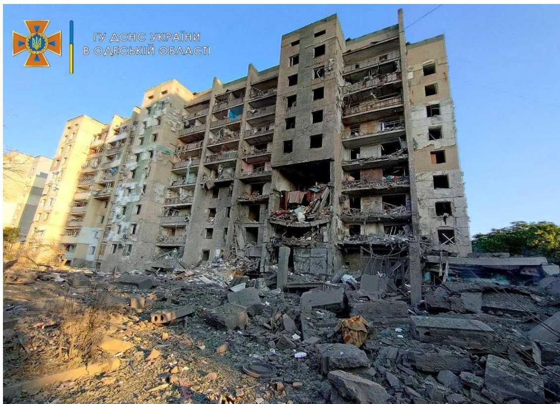
Рис. Ракетний обстріл, Сергіївка Одеська обл., 2023 р. Усі вікна і двері 1-7 етажів влетіли у кімнати з лудками. Людей на ліжках побило й засипало землею. Усі мешканці, хто рятувався у туалетних кімнатах, залишилися живими
