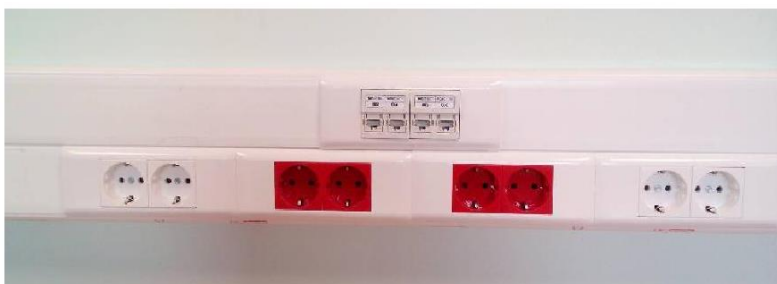
Розетки, підключені до системи безперебійного живлення (червоного кольору) у коробі на стіні офісного приміщення
