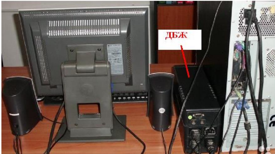
Живлення робочої станції (системного блока та монітора)
